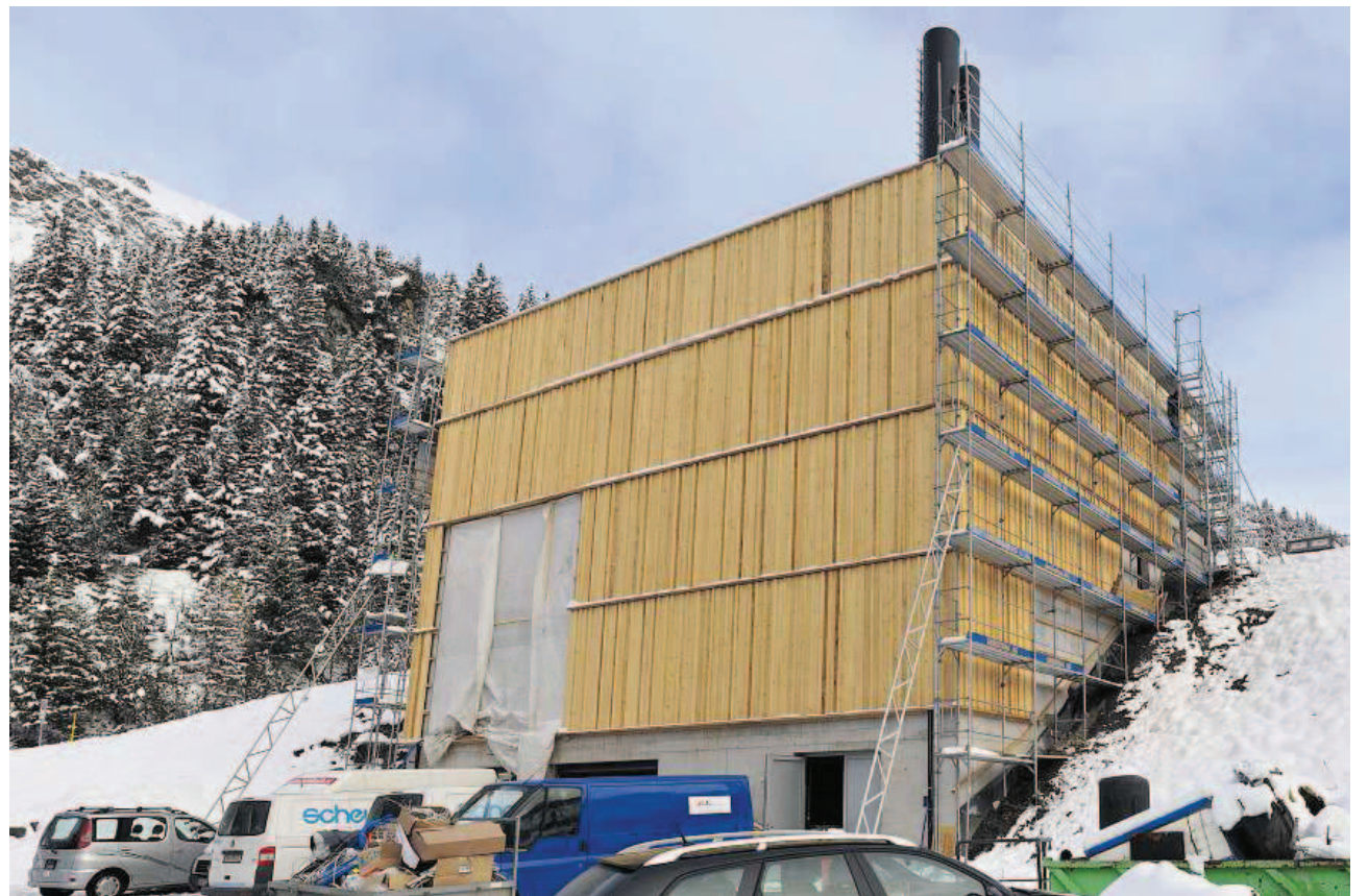
In Betrieb: Das Holzheizwerk in Malbun liefert bereits Fernwärme. Trotzdem soll auch dieses Projekt vom Staat gefördert werden. Der Landtag muss sich dazu heute mit einer Motion befassen. Bild Klaus Schädler
